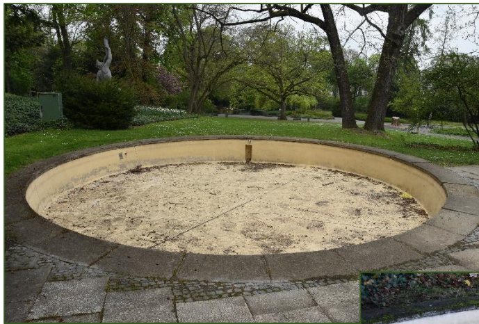
Abb. 96, 96a Abgelassenes, defektes Wasserbecken
