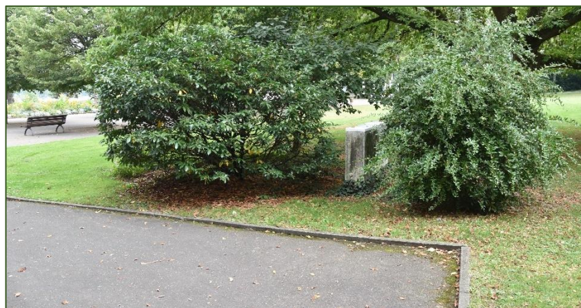
Abb. 296 Schaltkasten, durch Sträucher nur partiell verdeckt
