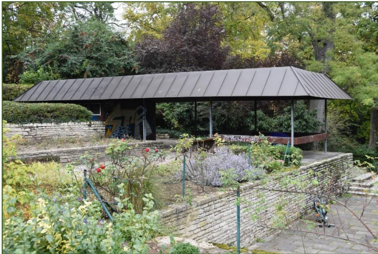
Abb. 130 Sanierungsbedürftiger Pavillon an der Westseite des Lesegartens
