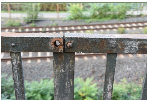
Abb. 376 Schadhafte Brüstungsgeländer der 1930er Jahre
